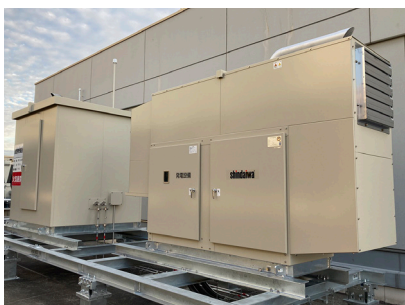
非常用発電機
